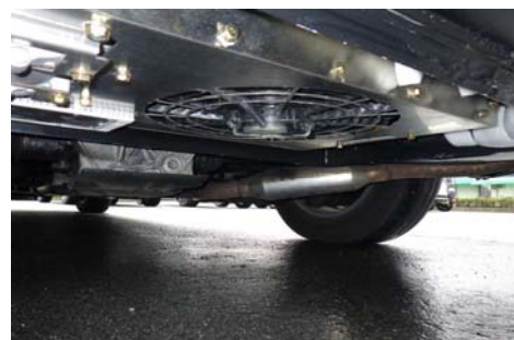
☆室外機設置状況 ・スペアタイヤスペースを利用して設置。 ・完全室外への排気が可能。
